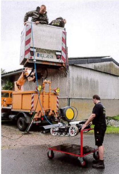
Am Haken aufgehängt setzt ein Helfer das mit Schlauchaufroller über 80 kg schwere Gerät auf einen selbst konstruierten Rollwagen ab.
